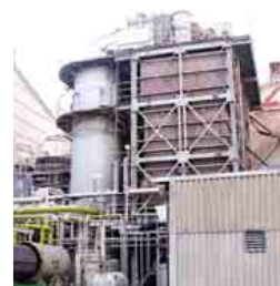
排煙処理設備
