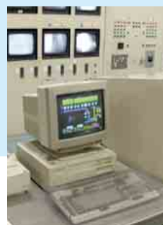
◀コンピュータによる調合管理
